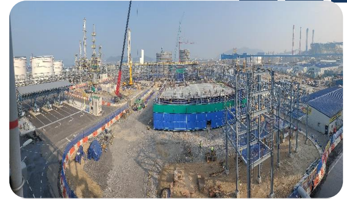
대산 현대오일뱅크 Bio Project
